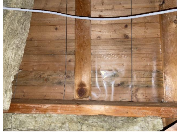
#26 Prøve P/T8 er udtaget fra misfarvning på overside af loftbrædder.
