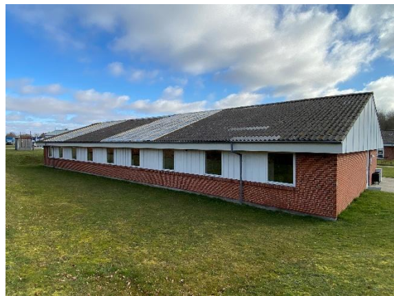
#4 Bygning 2, tag er lokalt afdækket med presenninger.
