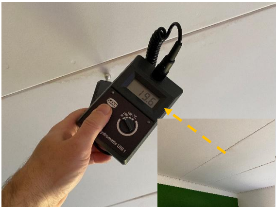
#15 Værelse 108, fugtskjolder på loft efter vandindtrængning. Loft måles tørt.
