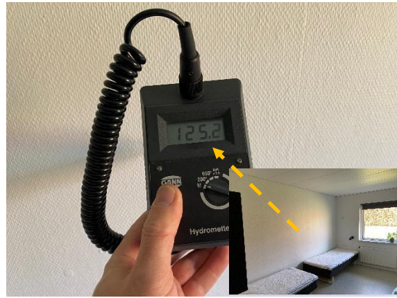
#20 Størstedelen af væggen mellem værelse 104 og 105 måles fugtig.
