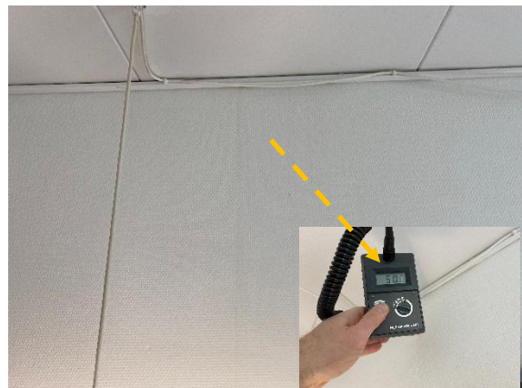
#18 Værelse 309, fugtskjolder på væg efter vandindtrængning. Væg måles tør.
